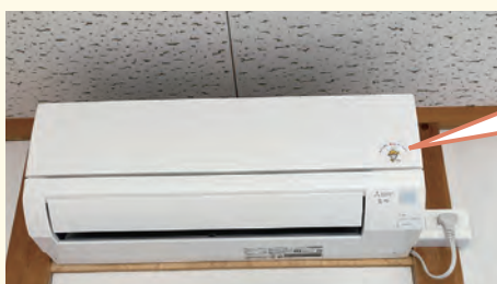
▲新設されたエアコン
