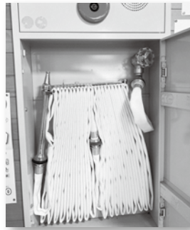
屋内消火栓設備
