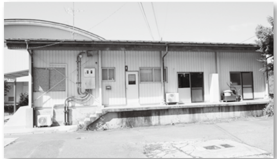
老朽化が進む西部給食センター
