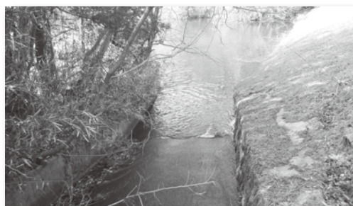
水漏れがある中地区のため池
