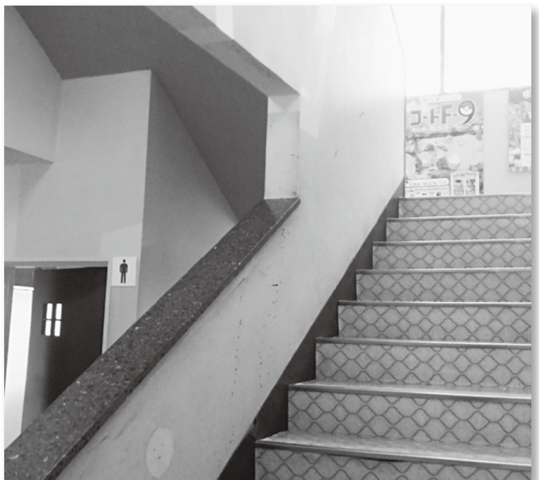
階段壁の汚れが目立つ須釜公民館
