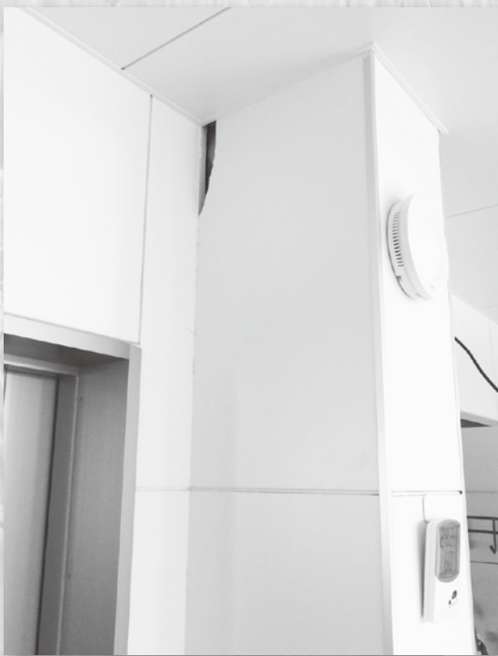
地震により被災した給食センター
