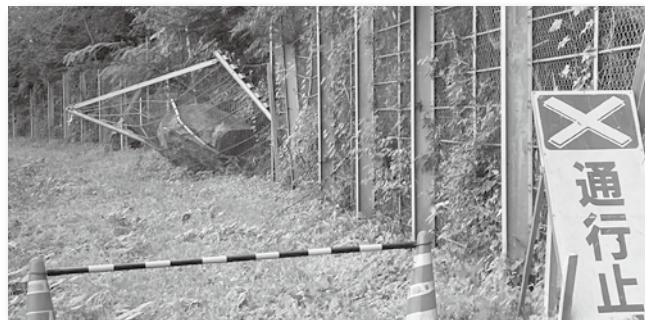
岩石の崩落現場
