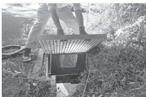
盗難防止策がとられたグレーチング
