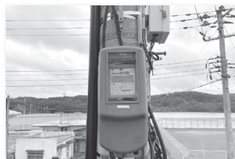
たまかわ文化体育館 電気メーター
