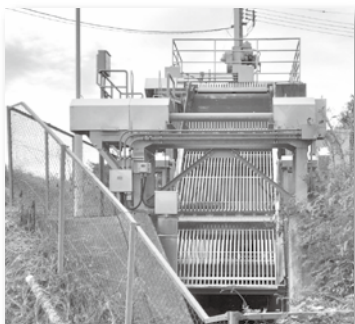
湛水防除機（排水ポンプ）
