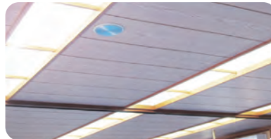
蛍光灯からLEDへ変更となった照明
