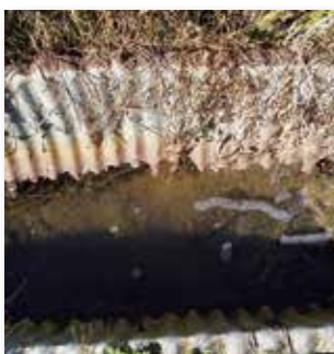
底が抜けた排水路(南須釜地区)
