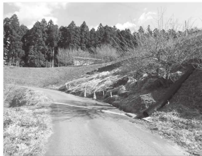
桜窪地内の土手崩れ
