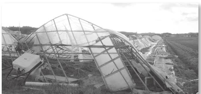
中地区のハウス倒壊
