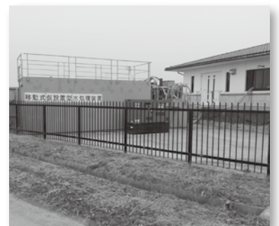
移動式仮設浄化槽(竜崎)
