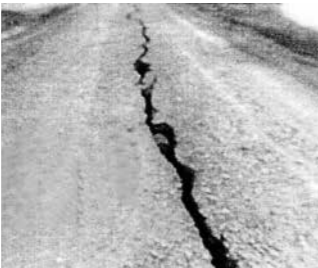
阿武隈川堤防の亀裂のようす
