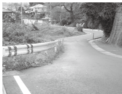
改良されていない箇所
