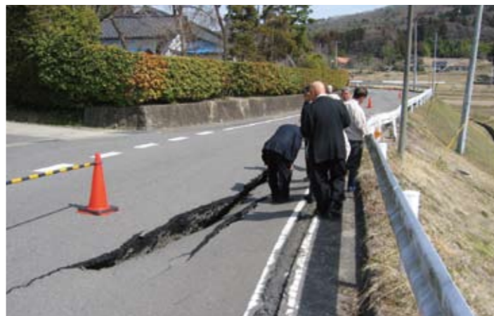
岩法寺字竹ノ内地内の村道の地割れ
