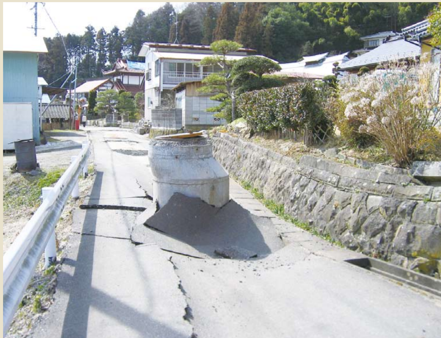
3月11日発生の大地震により下水道のマノホールがせり上がった(竜崎の靴屋地内)
