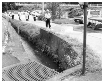
川辺字二ノ鳥居地区の請願箇所
