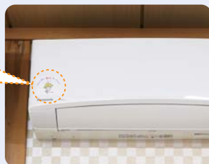
新設されたエアコン
