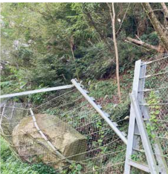
川辺字金波地内（崩落現場）
