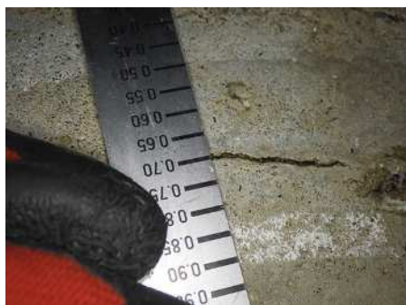
27. 44号橋：RCT桁橋 (橋長：7.40m、1965年竣工) 橋台パラペット前面の水平方向ひびわれ ※雨水の浸入により、損傷は進行する可 能性がある。(迂回路有り)
