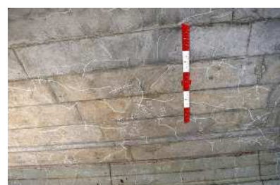
損傷状況（頂版下面ひびわれ）
