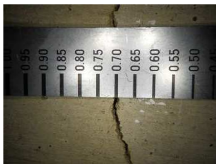
38. 兎田橋：鋼I桁橋 (橋長：23.40m、1994年竣工) 橋台前面の鉛直方向ひびわれ ※雨水の浸入により、損傷は進行する可 能性がある。(迂回路有り)
