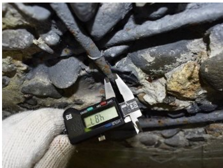
04. 5号橋：RC床版橋 (橋長：3.50m、1962年竣工) 露出鉄筋の著しい断面減少 ※露出した鉄筋は腐食が進行し、鉄筋破断 へと進展する可能性がある。 (迂回路有り)
