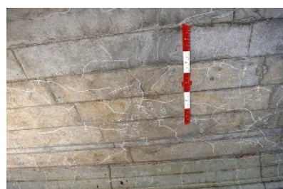
損傷状況（頂版下面ひびわれ）
