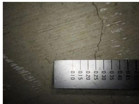
10. 玉川橋：鋼H桁橋 (橋長：16.67m、1985年竣工) 床版下面の橋軸直角方向ひびわれ ※雨水の浸入により、損傷は進行する可 能性がある。(迂回路有り)
