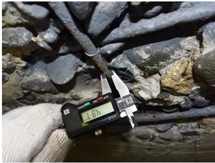
04. 5号橋：RC床版橋 (橋長：3.50m、1962年竣工) 露出鉄筋の著しい断面減少 ※露出した鉄筋は腐食が進行し、鉄筋破断 へと進展する可能性がある。 (迂回路有り)
