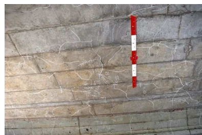
損傷状況（頂版下面ひびわれ）
