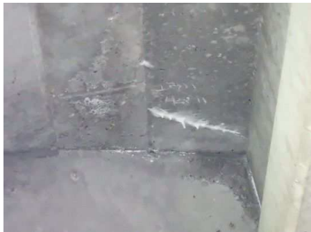
36. 尾礼の宮橋：プレテンT桁橋 (橋長：14.64m、1984年竣工) ポステン桁下面の遊離石灰を伴うひびわれ ※雨水の浸入により、損傷は進行する可 能性がある。(迂回路有り)
